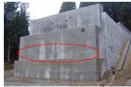
国土交通省北陸地方整備局長岡国道事務所発注 「国道253号庄之又川下部その2工事」
