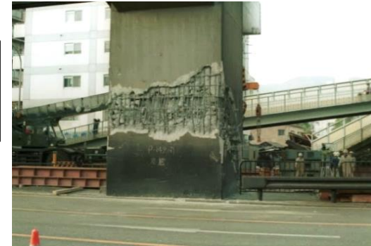
兵庫県南部地震によるRC柱の損傷
