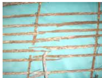
写真-2 第4径間G1 最劣化部
